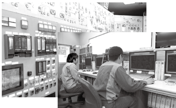
▲写真1 制御パネル（左）とコントロールルーム
